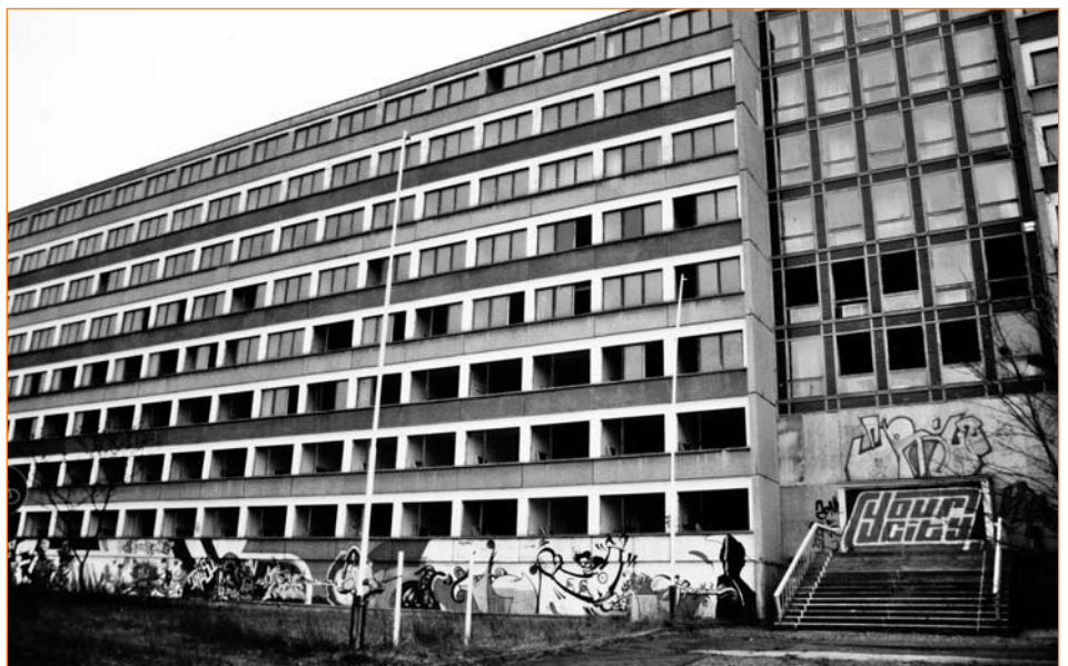
Um das ehemalige Lehrlingswohnheim der Wismut vor weiterem, wachsenden Vandalismus, aufgrund seines Leerstandes zu schützen, entfernte der Eigentümer Wismut GmbH die Fenster und wird diese mit Platten vor weiteren Übergriffen schützen. (Foto: Kreß)
